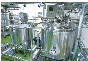
2階の調製エリアに設置されたゼリー仕込み用タンク群。高度な清浄度が保たれた区画で、安全な中身が作られる
